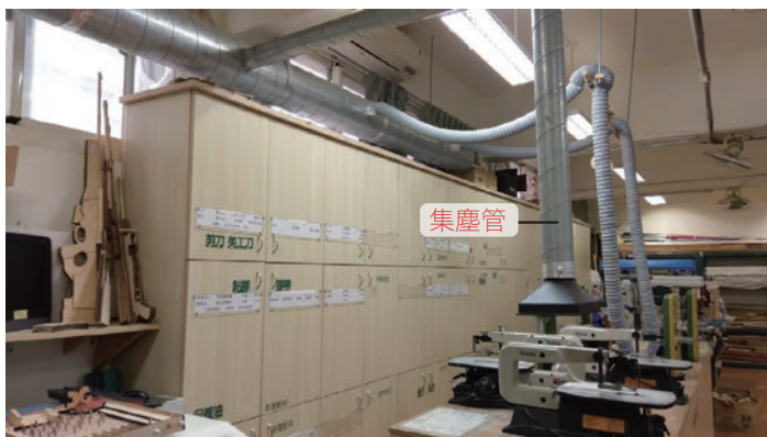
▲圖2-1-17 除塵設備。線鋸機上方設有集塵管，可吸收鋸切時產生的粉塵。
