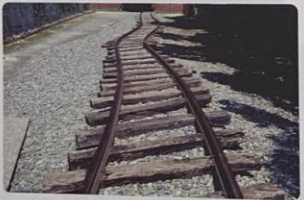
⑤ 鐵軌變形彎曲 (南投縣集集鐵路，民國88年)
