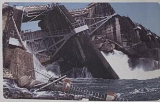
⑥ 水壩破裂 (臺中市石岡水壩，民國88年)
