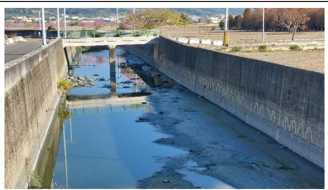
02 解說彰化縣河圳溝泥沙淤積情形
