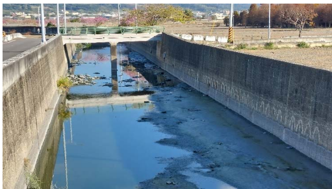
02 解說彰化縣河圳溝泥沙淤積情形
