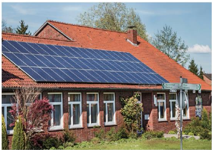
▲圖 1-16 安裝在屋頂的太陽能發電板，可以提供家中的電力來源。
